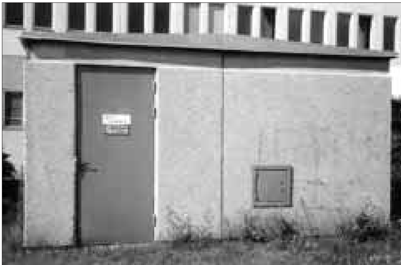
Bild 1: Provtagningsplats av fog på elnätstation. Här innehöll fogen totalt cirka 2 kg PCB.
