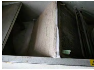
Ventilation. Litet ventilationsaggregat för personalrum i hus F, behöver rengöras
