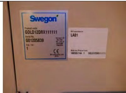
Ventilation. Ett Swegon Gold RX 12 i hus B
