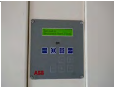
Ventilation. Den interna styrningen för ett klassrumsaggregat i hus C1
